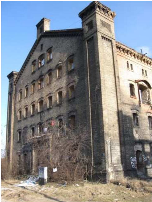
17. Wypalony budynek Zakładów Mięsnych
